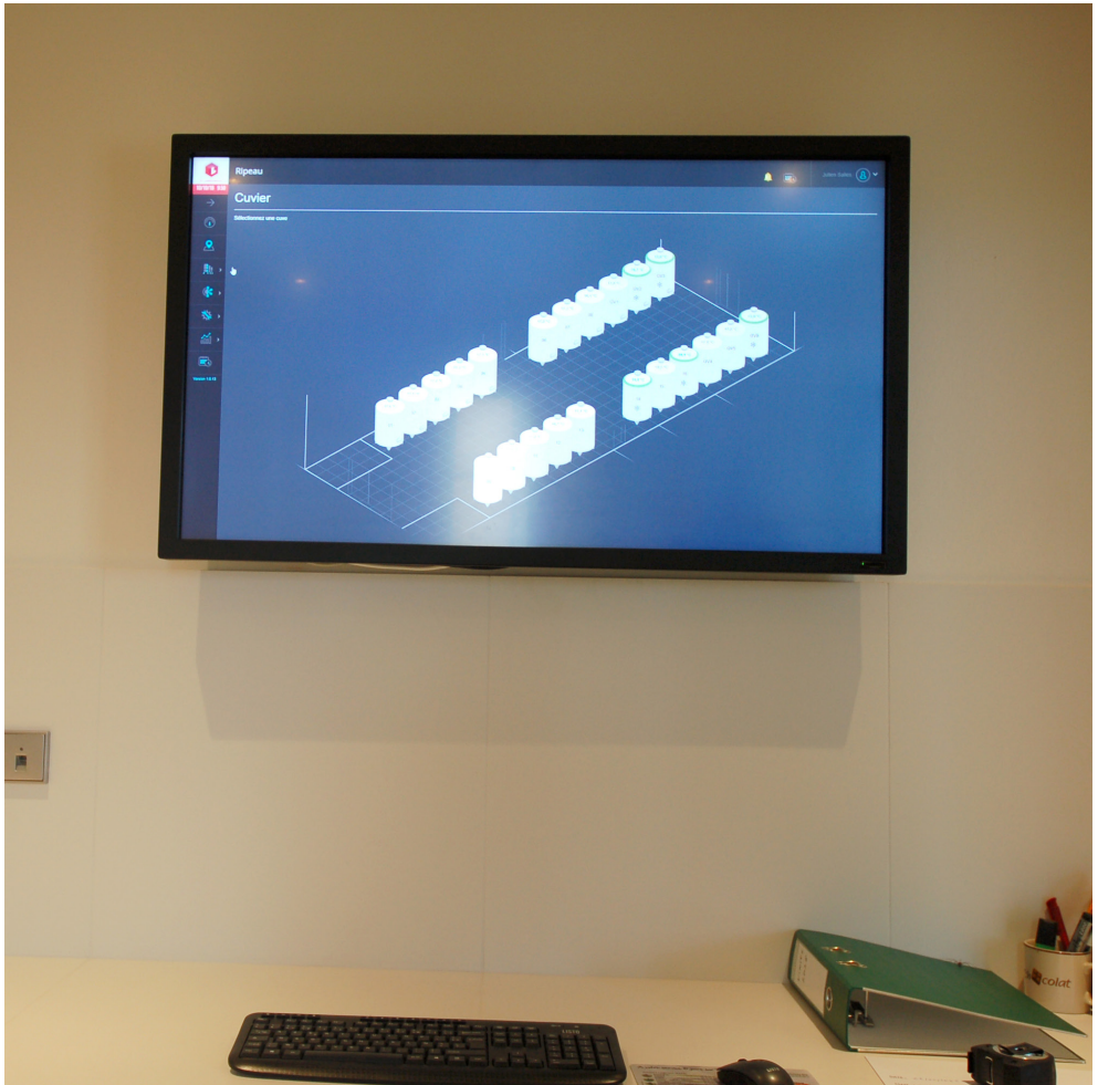
Interface tactile 42" avec supervision LAMBOX Château Ripeau (Saint-Emilion) / Installation 2018
