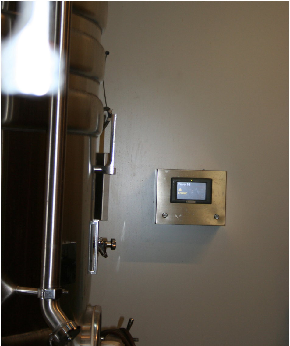
Interface console 7" Château Mauvesin-Barton (Moulis-en-Médoc) / Installation 2013
