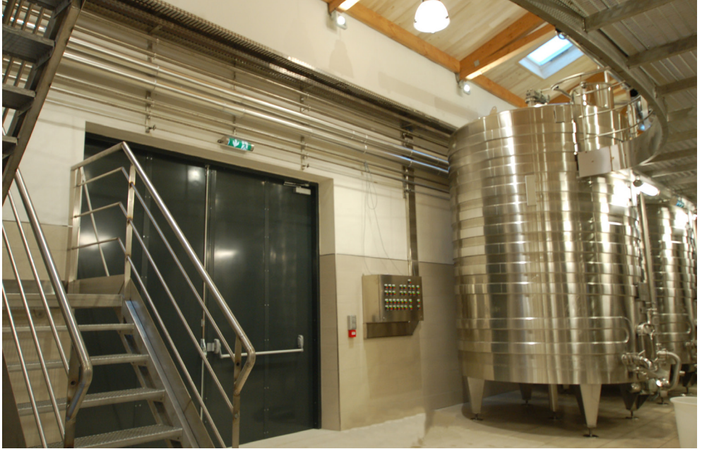
Régulation avec régulateurs Château Jacques Blanc (Saint-Emilion) / Installation 2018
