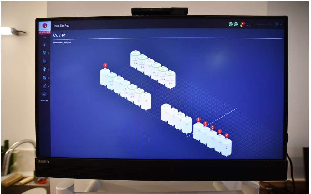
PC tactile 32" avec supervision LAMBOX Château Tour de Pez (Saint-Estèphe)/ Installation 2020
