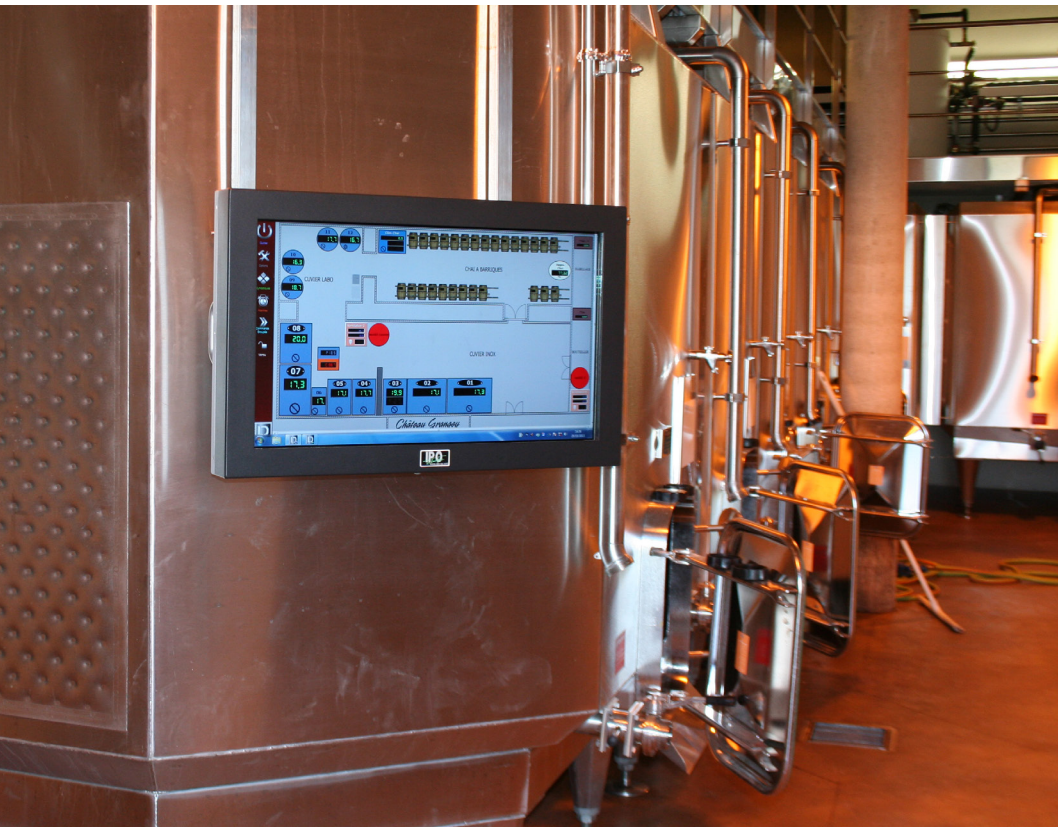
Interface 32" tactile Château Grangey (Saint-Christophe-des-Bardes) / Installation 2013
