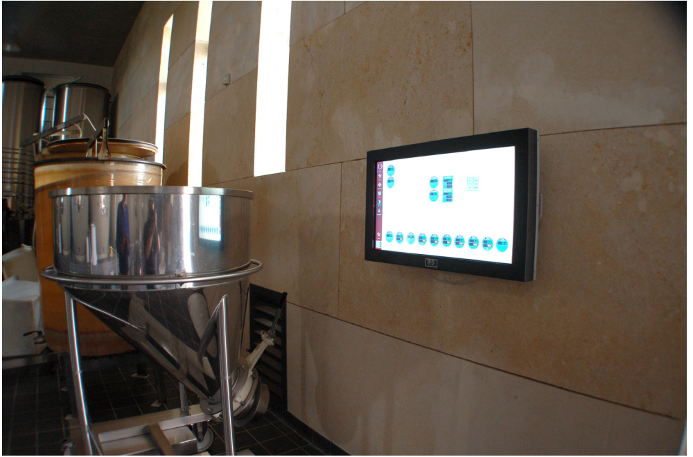
Interface PC tactile 32'' Château Croix de Gay (Pomerol) / Installation 2014
