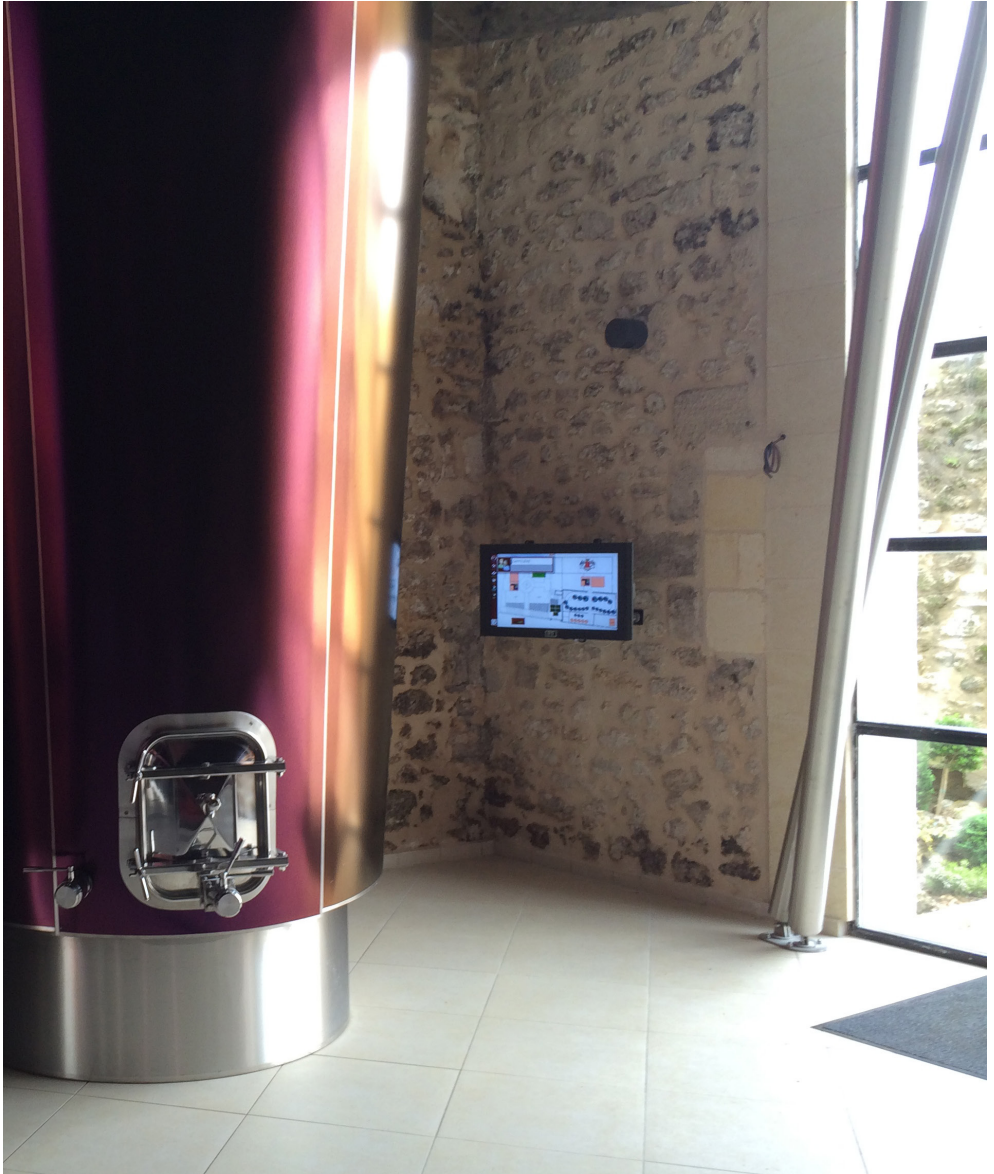
Interface PC tactile 32'' Château La Gaffelière (Saint-Emilion) - Installation 2013
