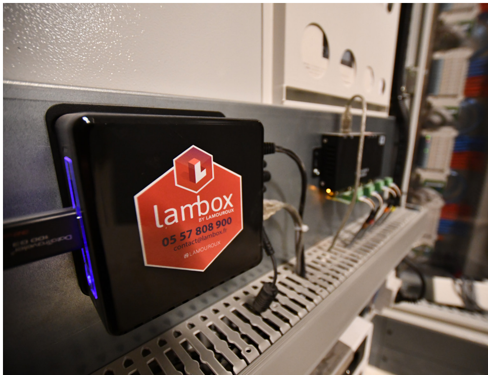
Armoire de régulation Vinitactile + LAMBOX Château Taffard de Blaignan (Ordonnac) / Installation 2021
